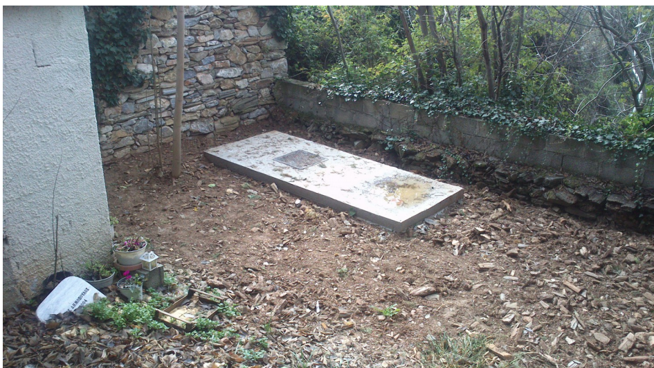
Εικ. Σηπτικός βόθρος στο κοιμητήριο Στρόφιλος – Αγ. Βλασίου
