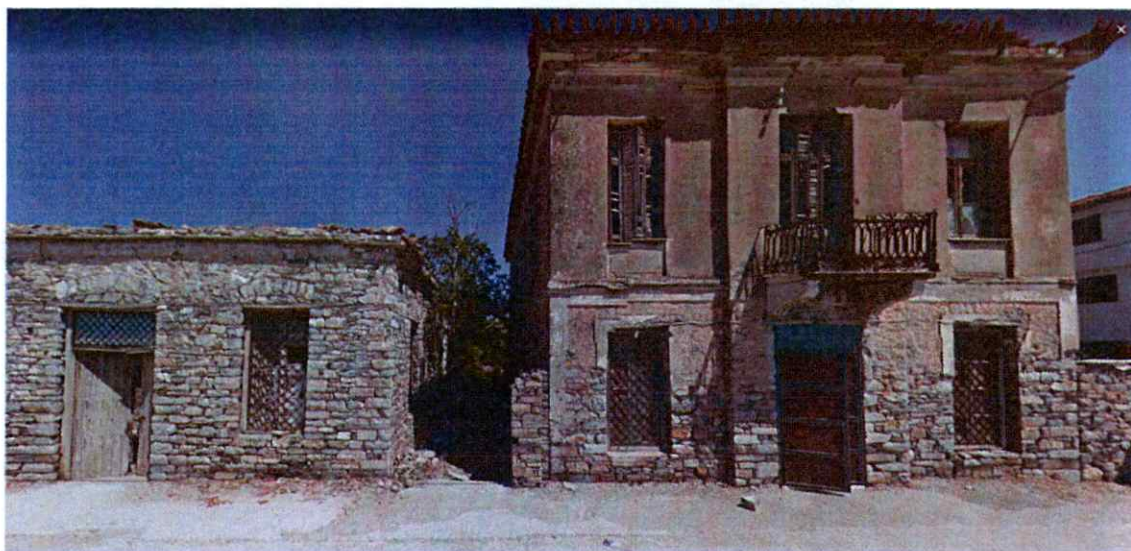
Εικ. 8. Οψη της πέτρινης αποθήκης και της δώροφης κατοικίας από την Ηρ. Πολυτεχνείου - απόσπασμα Google maps
